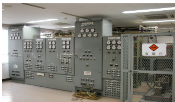
図4 模擬電力系統試験装置 (6 kVA/220 V/ 3300 V送電線模擬)
